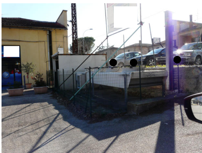
Foto 4.6 – Immobile 4: Vista delle apparecchiature impiantistiche esterne dell'immobile 2
