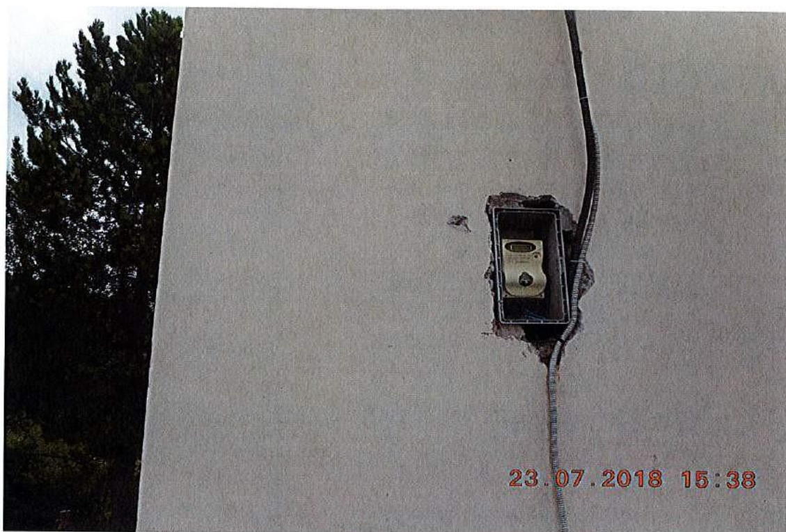
Particolare contatore su parete esterna
