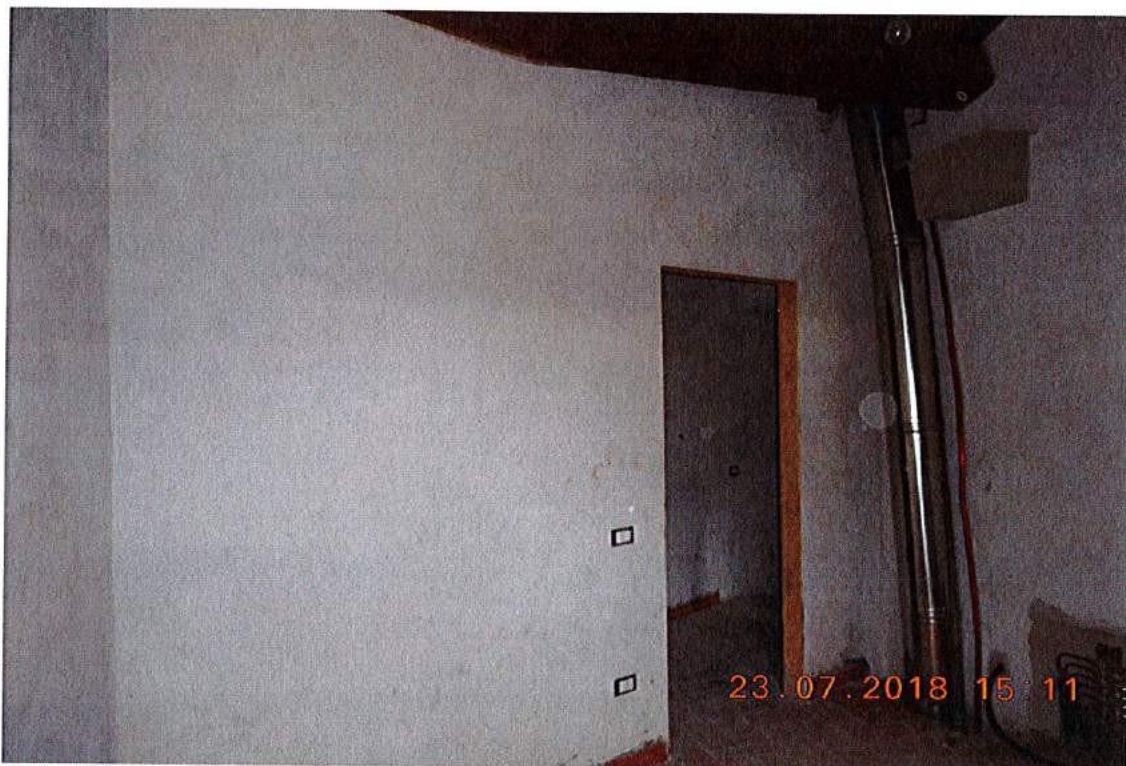
Particolare canna fumaria e collettore interni alla camera doppia
