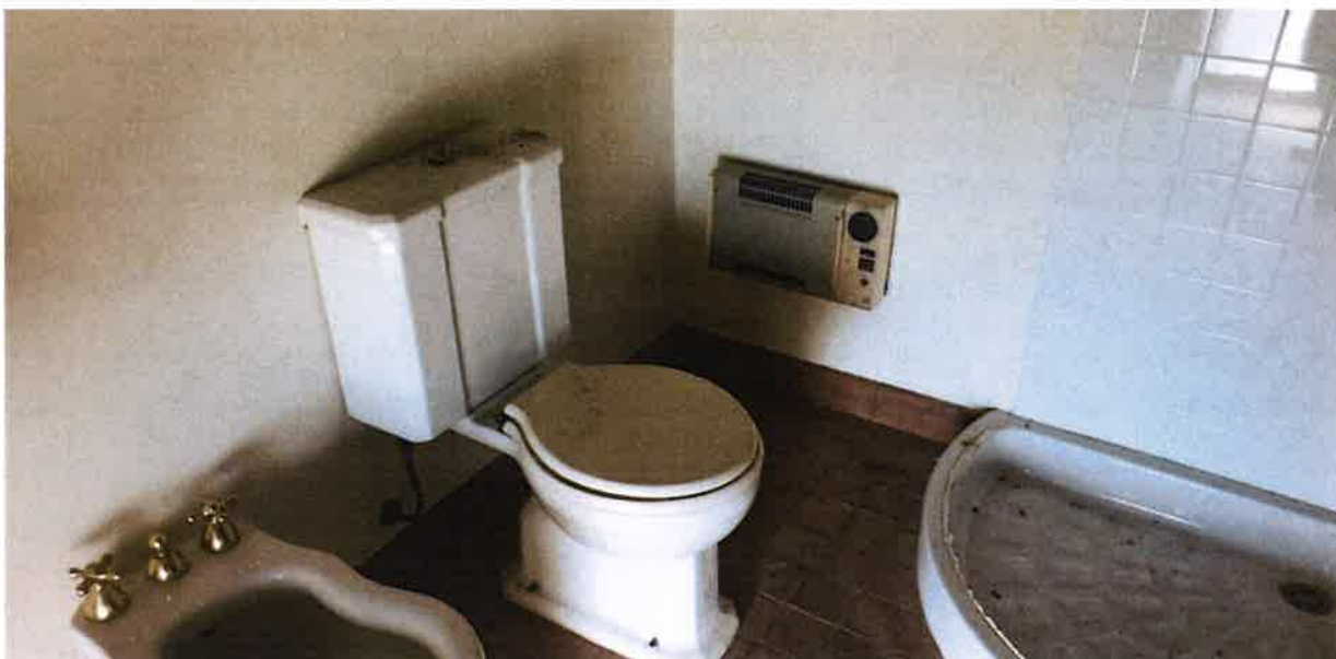
Foto n° 21: sanitari del bagno al piano primo
