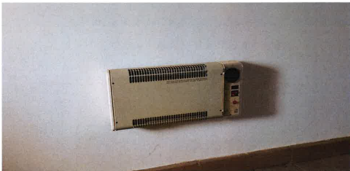
Foto n° 24: convettore elettrico per riscaldamento per tutti i vani
