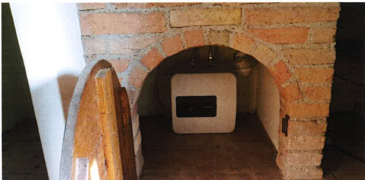
Foto n° 27: scaldabagno acqua calda della cucina
