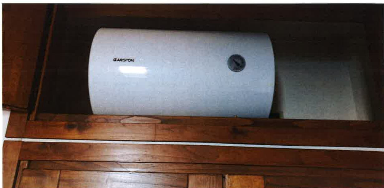
Foto n° 26: boiler acqua calda del bagno
