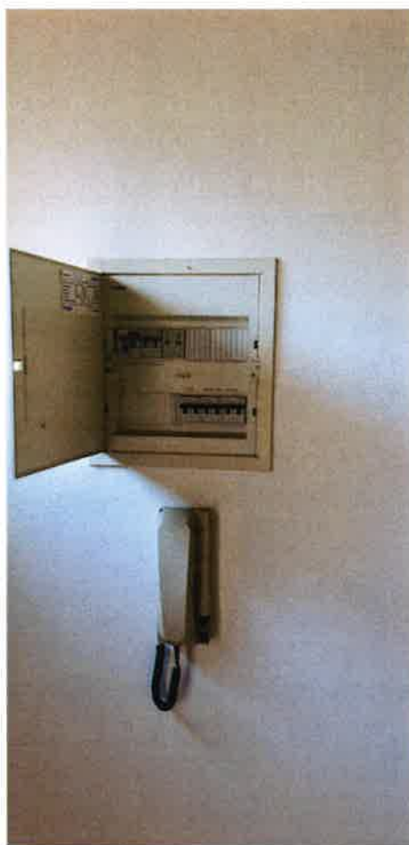
Foto n° 25: particolare quadro elettrico e citofono
