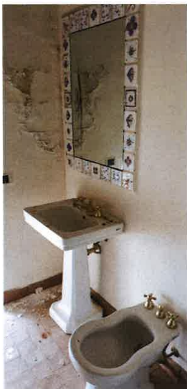
Foto n° 20: sanitari del bagno al piano primo ( si notano tracce di umidità sulla parete )
