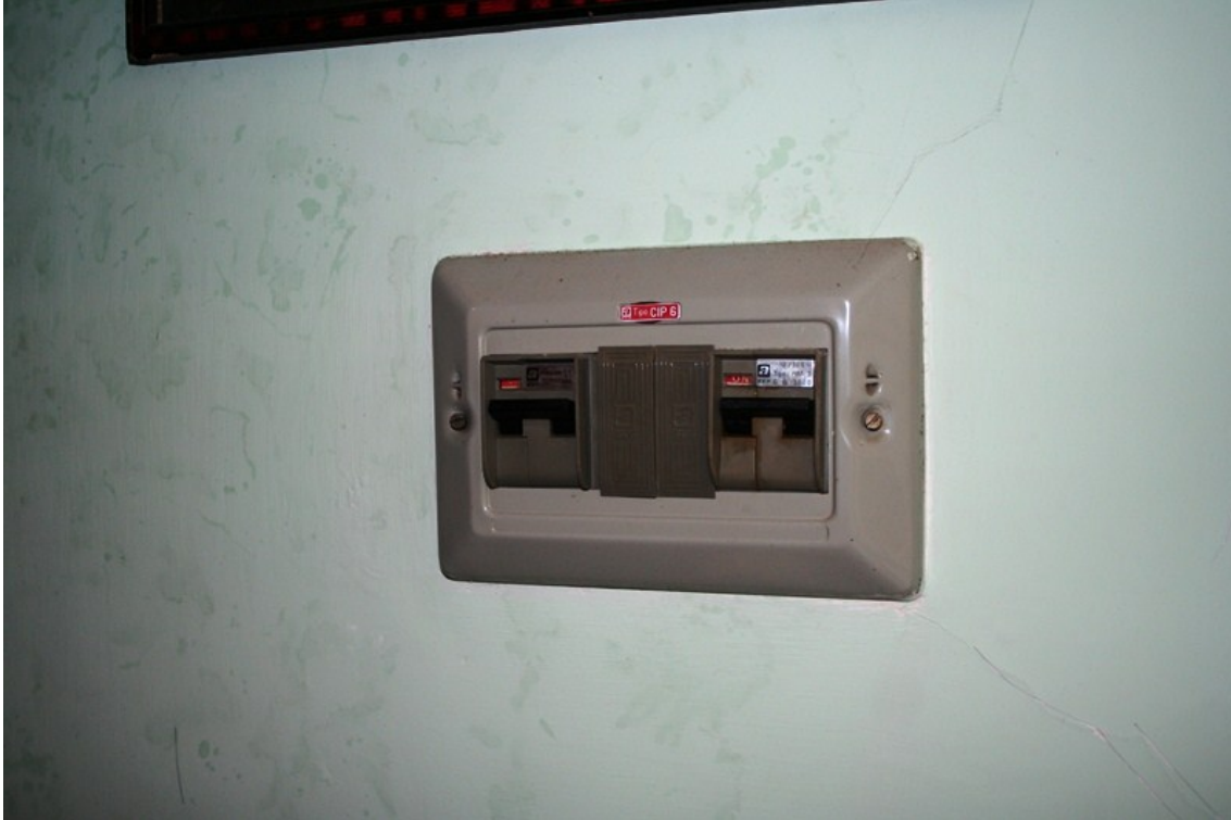
FOTO N° 7 Vista Interna - U.I. 1 - Centralino Aut.co Salvavita
