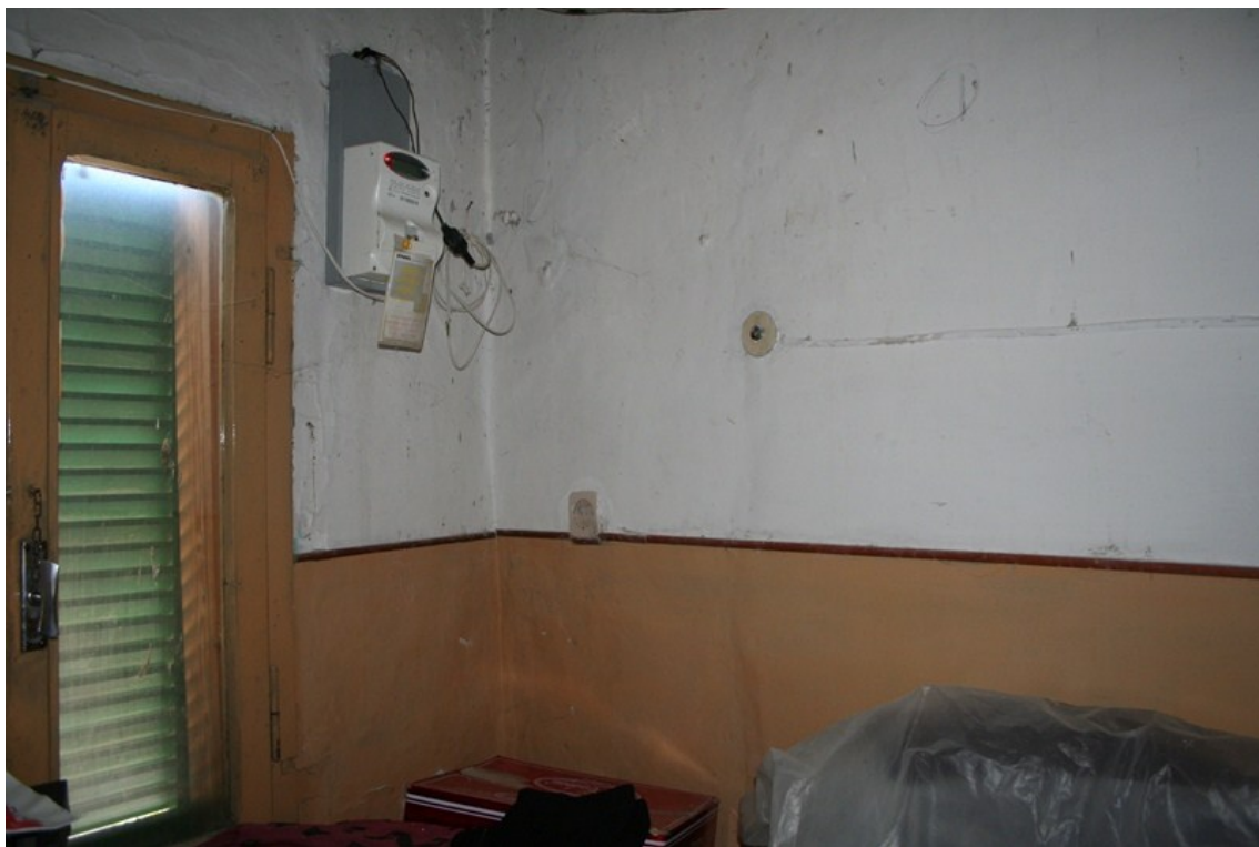
FOTO N° 14 Vista interna – U.I. 3 – cucina-contatore Enel e particolare impianto elettrico
