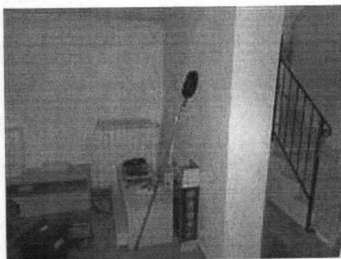
Piano interrato con impianto di riscaldamento
