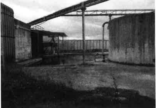
Vasche impianto biogas
