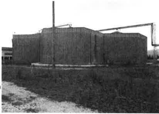
Cisterne impianto biogas
