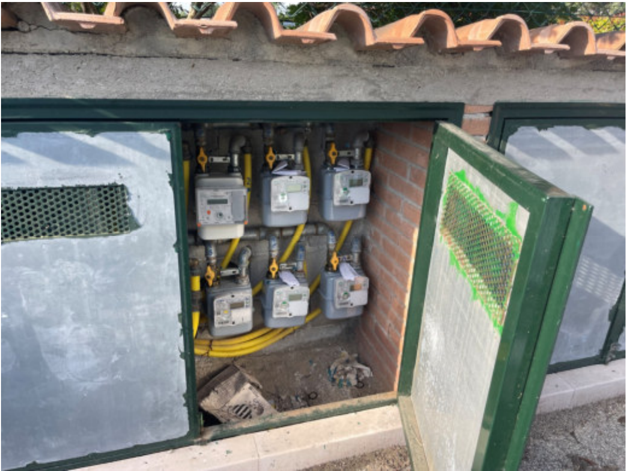
Foto n° 91: vano contatori dell'utenza gas del fabbricato posto in Deruta, Strada Esterna Vicinale del Moronaro n° 1
