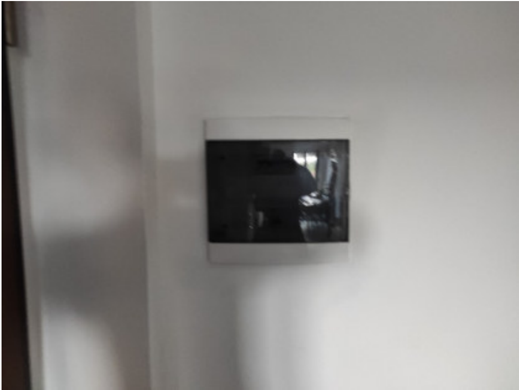
Foto n° 53: quadro elettrico dell'unità immobiliare n° 1252/5
