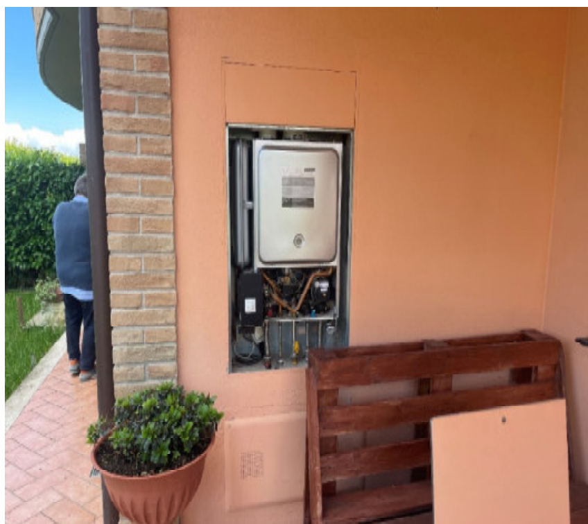
Foto n° 17: caldaia dell'unità immobiliare n° 1252/1-1257(graffata)
