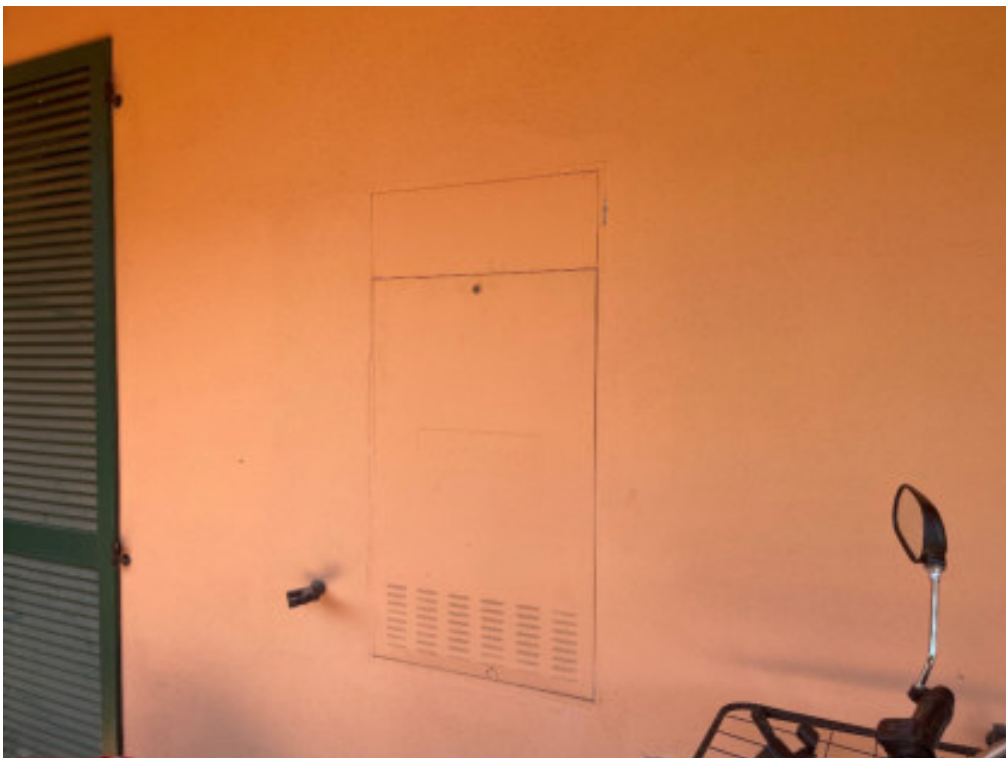
Foto n° 34: caldaia dell'unità immobiliare n° 1252/3-1269(graффata)
