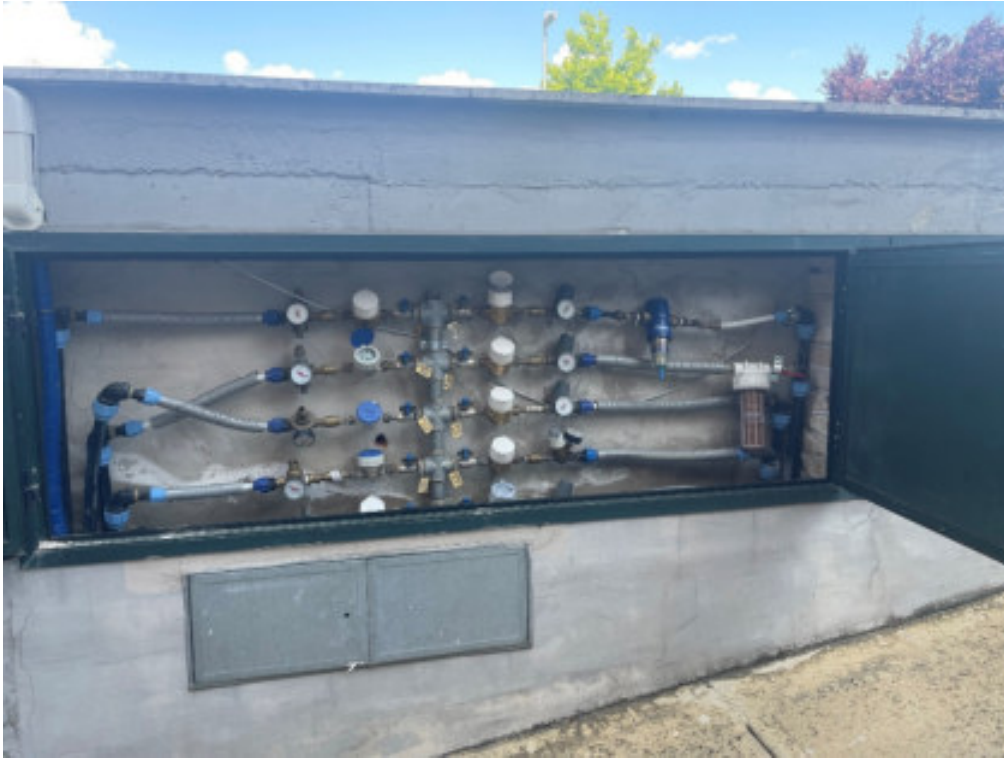
Foto n° 67: vano contatori dell'utenza acqua domestica del fabbricato posto in Deruta, Via della Speranza n° 6
