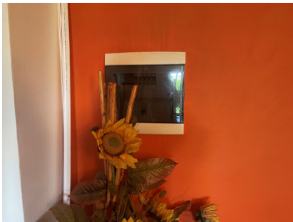
Foto n° 18: quadro elettrico dell'unità immobiliare n° 1252/1-1257(graffata)Foto n° 19:
