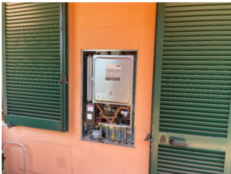
Foto n° 26: caldaia dell'unità immobiliare n° 1252/2-1267(graiffata)
