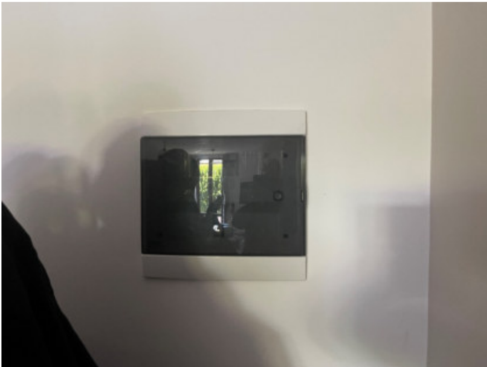
Foto n° 44 : quadro elettrico dell'unità immobiliare n° 1252/4-1256(graffata)
