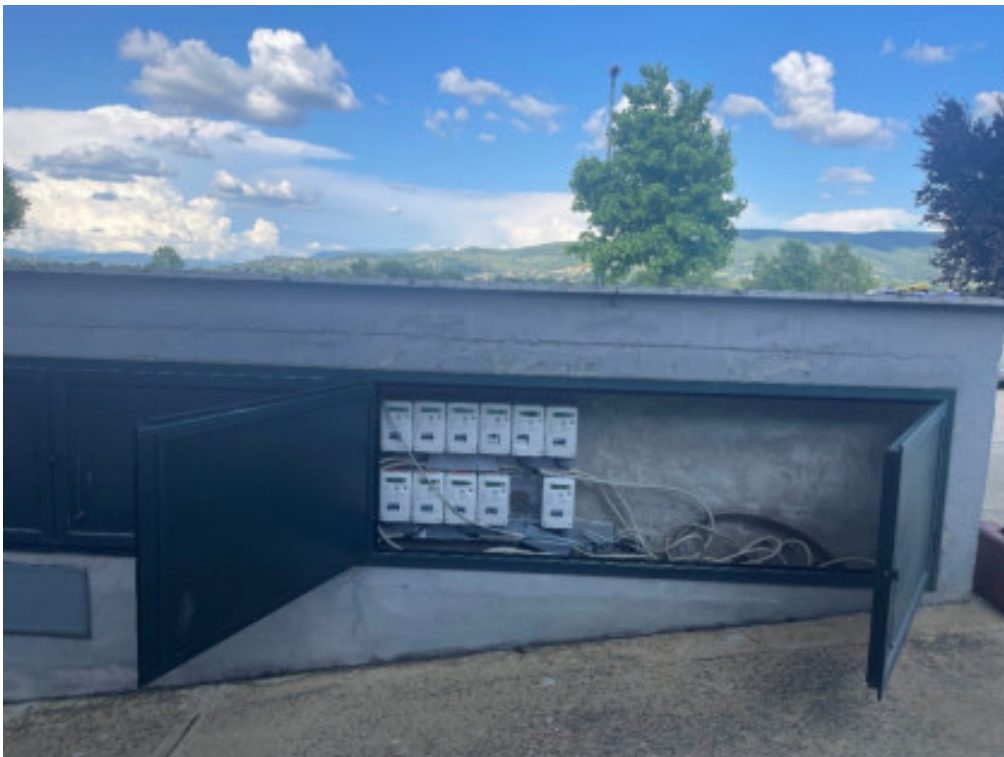
Foto n° 68: vano contatori dell'utenza energia elettrica del fabbricato posto in Deruta, Via della Speranza n° 6
