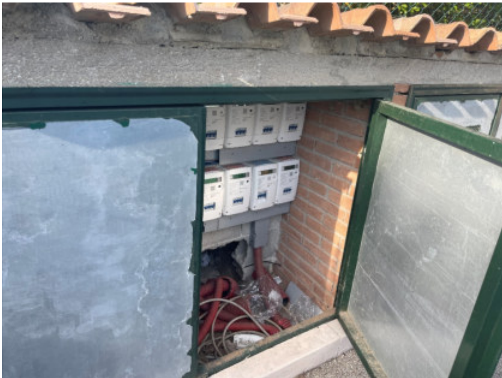
Foto n° 92: vano contatori dell'utenza energia elettrica del fabbricato posto in Deruta, Strada Esterna Vicinale del Moronaro n° 1
