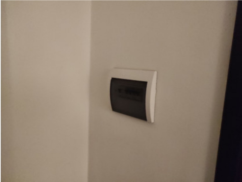
Foto n° 87: quadro elettrico dell'unità immobiliare n° 1188/23
