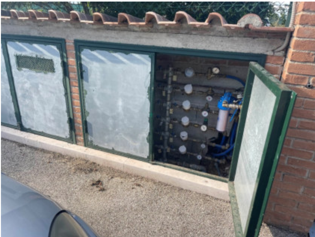
Foto n° 90: vano contatori dell'utenza acqua domestica del fabbricato posto in Deruta, Strada Esterna Vicinale del Moronaro n° 1
