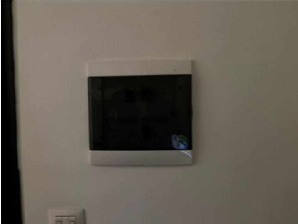
Foto n° 35: quadro elettrico dell'unità immobiliare n° 1252/3-1269(graffata)
