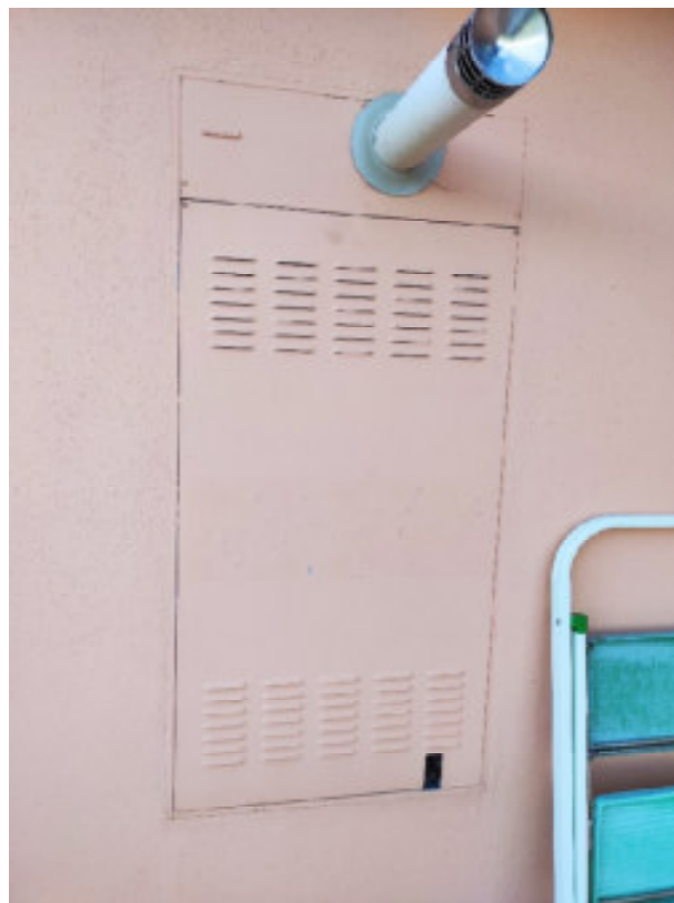
Foto n° 86: caldaia dell'unità immobiliare n° 1188/23
