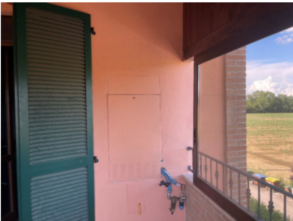
Foto n° 64: caldaia dell'unità immobiliare n° 1252/10
