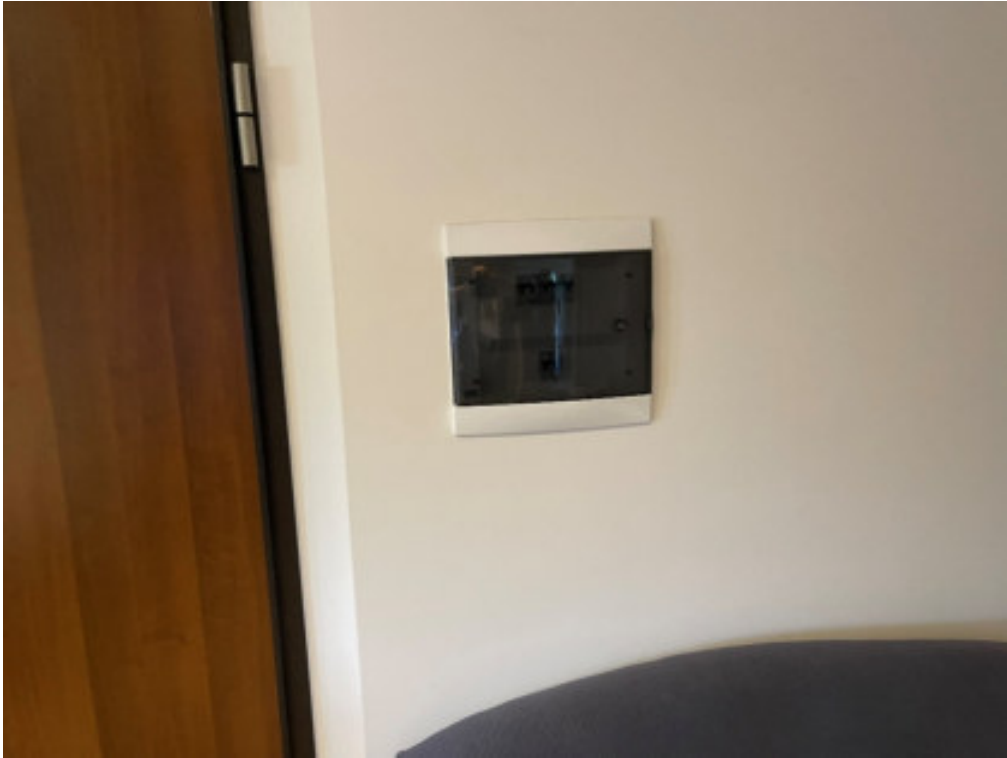
Foto n° 65: quadro elettrico dell'unità immobiliare n° 1252/10
