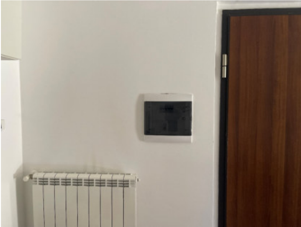
Foto n° 27: quadro elettrico dell'unità immobiliare n° 1252/2-1267 (graffata)
