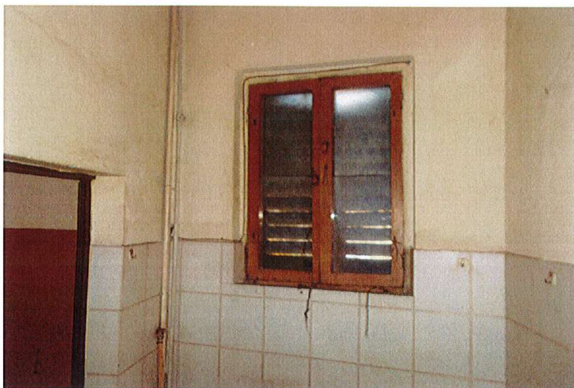
Particolare locale cottura
