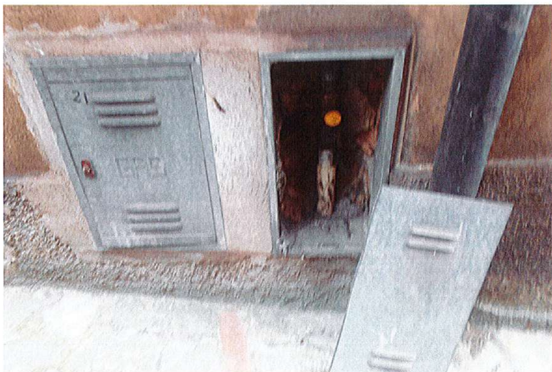
Zona contatori metano su alloggiamento esterno a fianco portone condominiale
