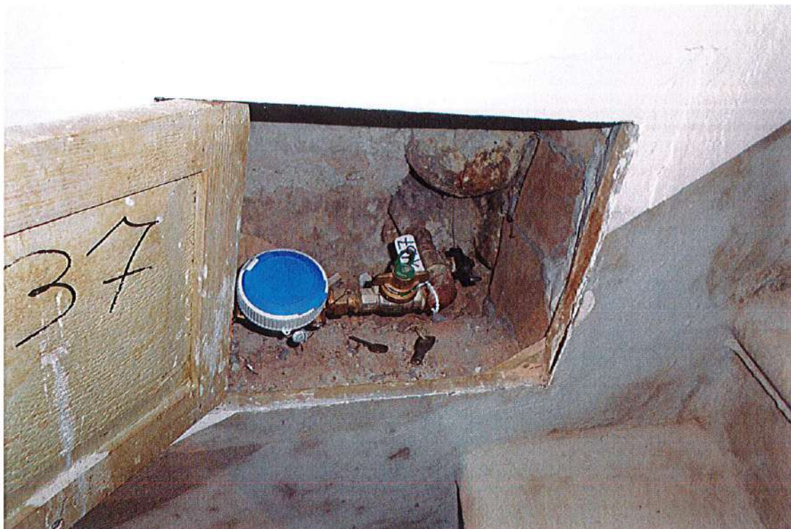
Zona contatori idrici su androne piano terra
