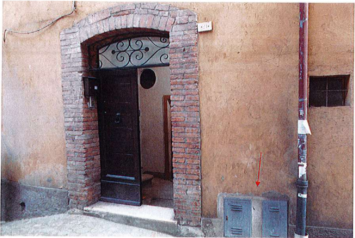
Portone di ingresso condominiale – alloggio contatori metano
